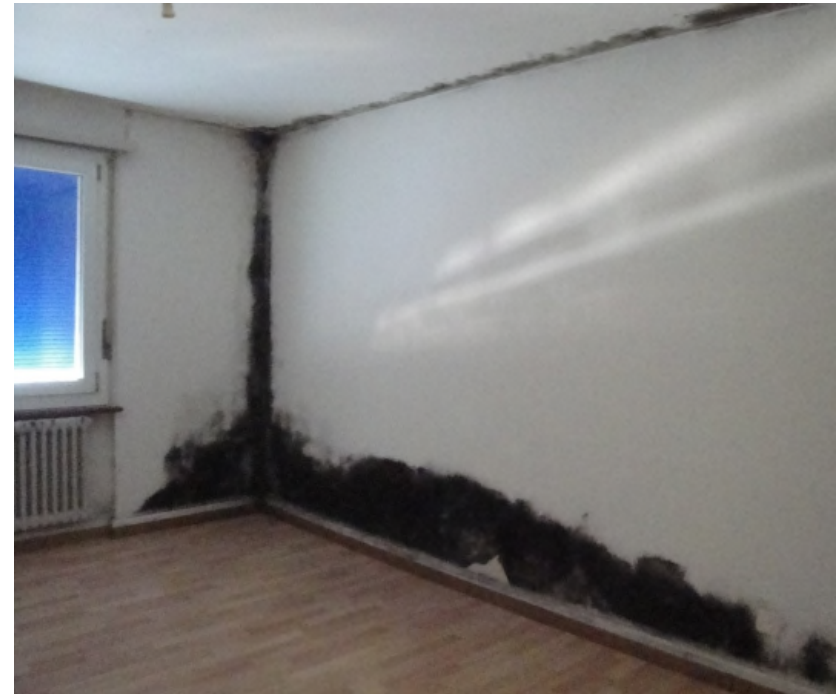
Apparition de moisissures
